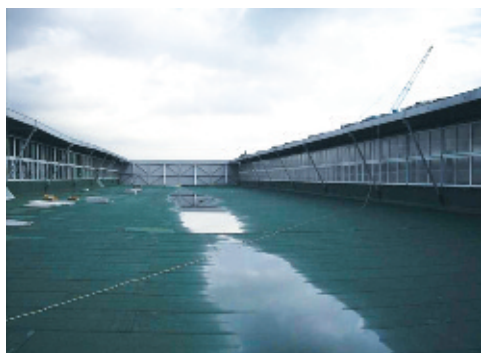
Застойные зоны, возникающие из-за ошибок в организации уклона кровли, — причина сокращения срока службы крыши
